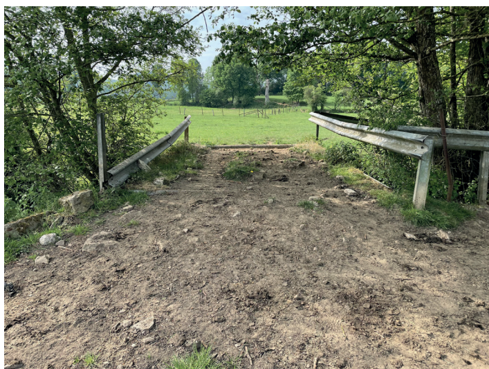
Eine Viehbrücke in einer Stahl-Holzkonstruktion ermöglicht den Übergang des Viehs auf die andere Uferseite. Das Holz für den Bau beider Brücken stammt aus den Wäldern des Forstreviers Beckerich.
